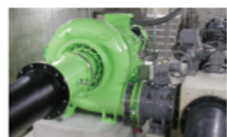
▲桜井浄水場小水力発電システム
