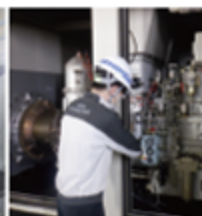
▲自家発電設備の点検業務
