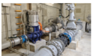
▲今泉配水場小水力発電システム
