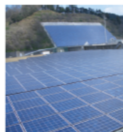
▲御所浄水場太陽光発電システム
