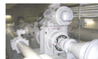
▲広域水道センター小水力発電システム
