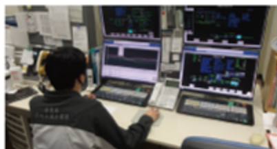
▲水道施設の運転監視業務
