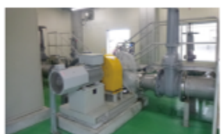
▲山崎浄水場小水力発電システム
