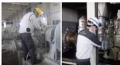
▲送水ポンプの点検業務
